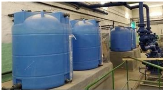
Рисунок 5. Оборудование станции водоочистки п. Вохтога
